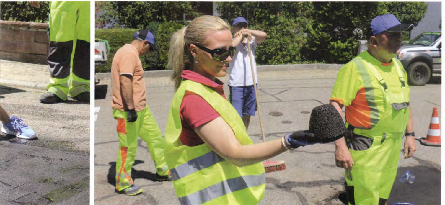
Michaela Steinger: Der Reaktivasphalt erreicht bereits zwei Stunden nach Einbau 5,7 kN Druckbelastung. (Quelle DAV/hin)
